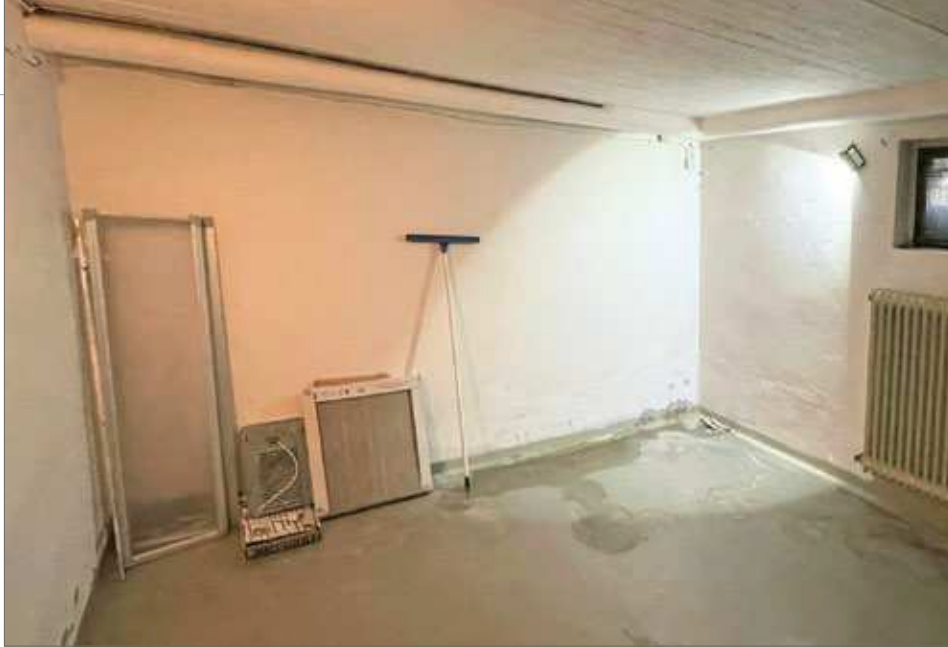
Bild 1: In einem Mehrfamilienhaus aus den 1990er Jahren drang Wasser immer wieder in einen Keller ein und machte eine Lagernutzung nahezu unmöglich.
