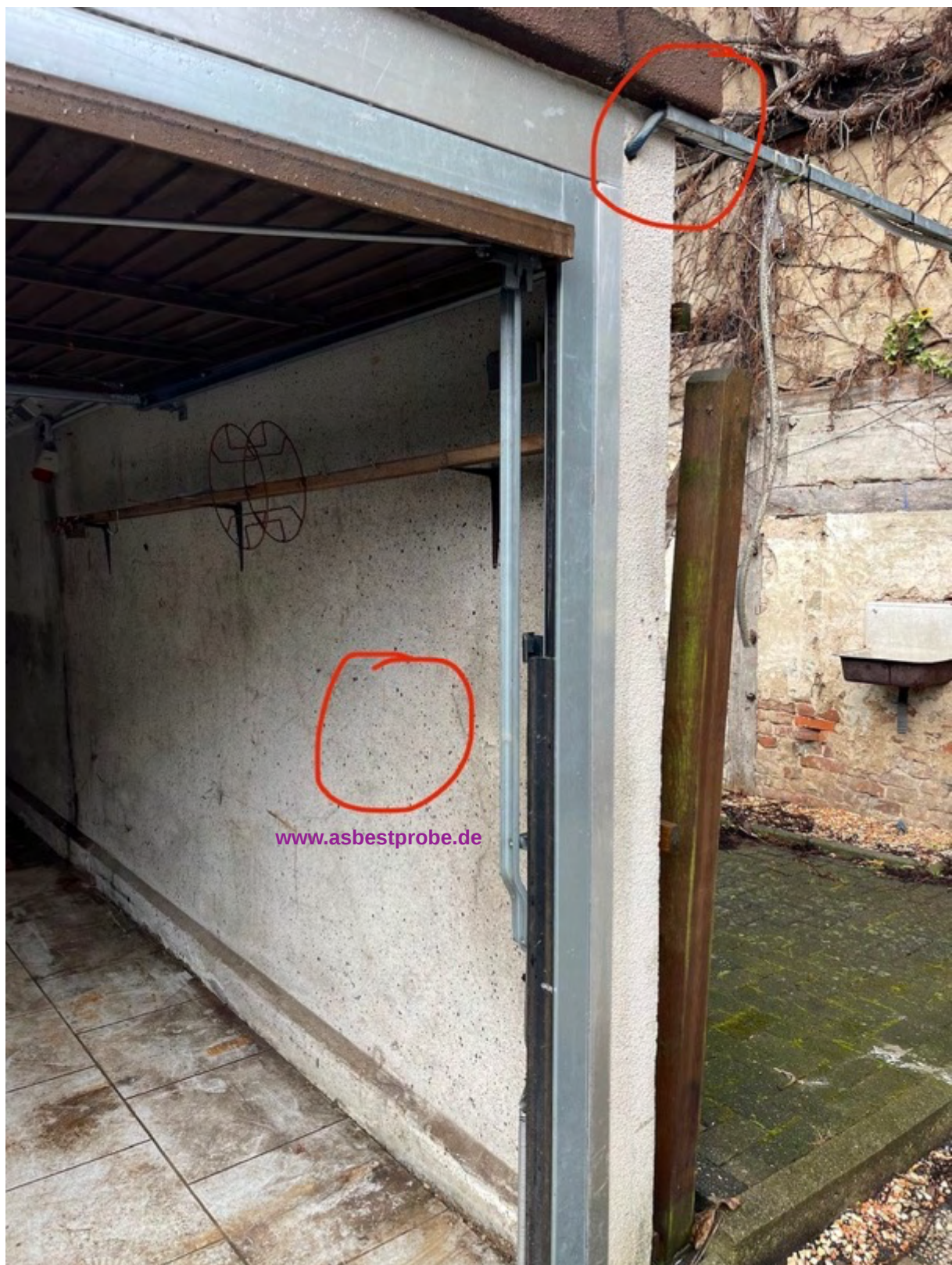
Abbildung 7: Fertiggarage mit Innen- und Außenputz asbesthaltig
