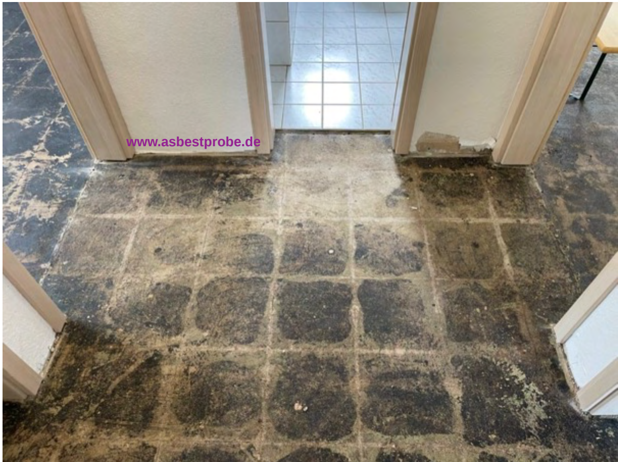
Abbildung 4: Asbesthaltiger Kleber eines Bodenaufbaus.
