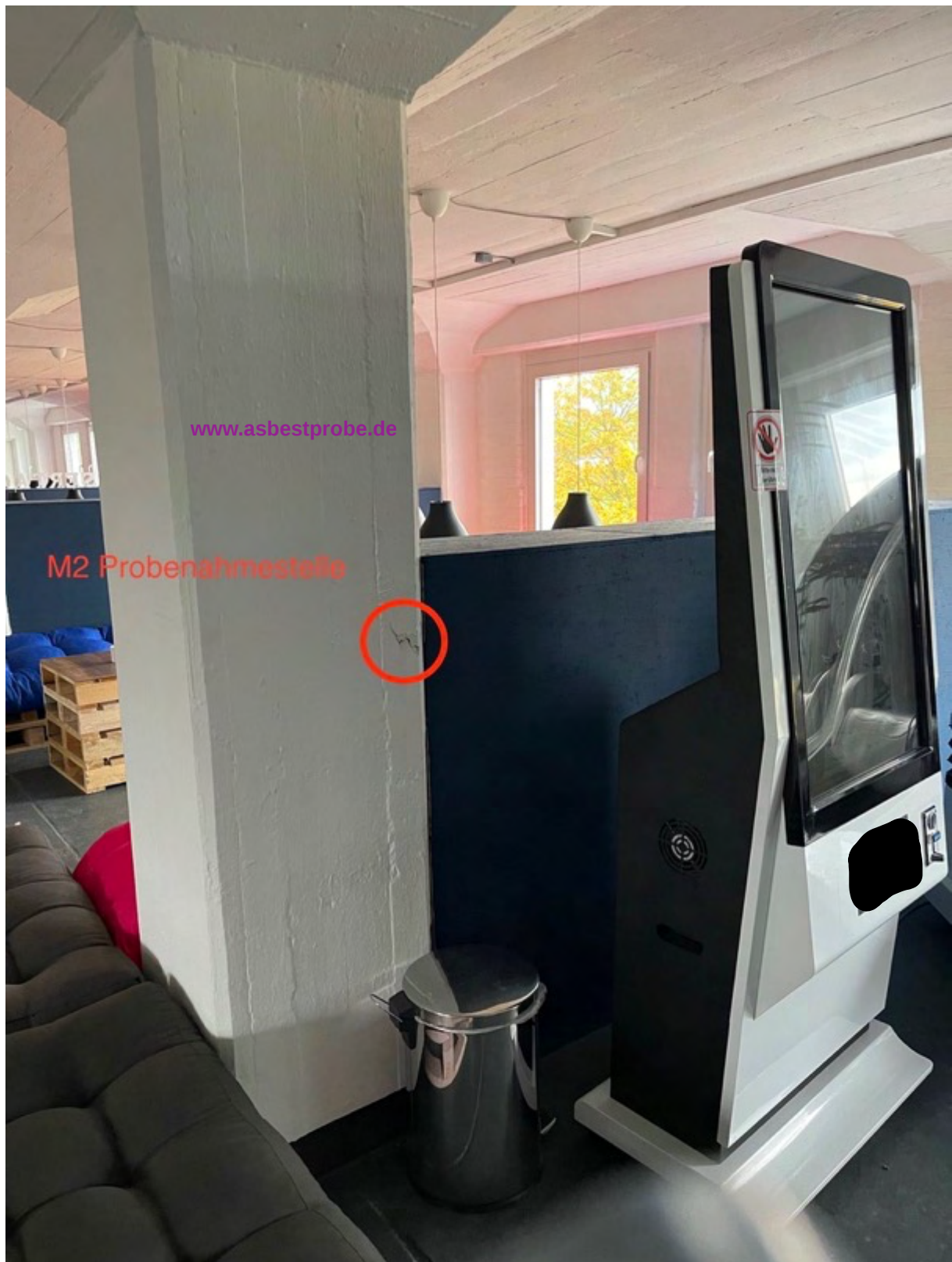
Abbildung 14: asbesthaltige Wandfarbe, weiß
