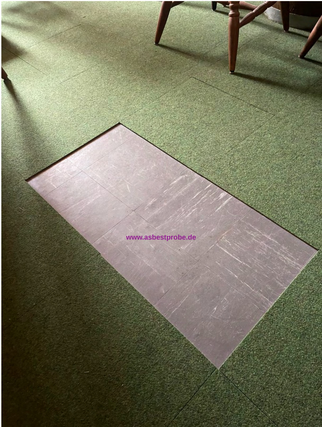
Abbildung 47: asbesthaltige PVC-Fliese unter Teppich
