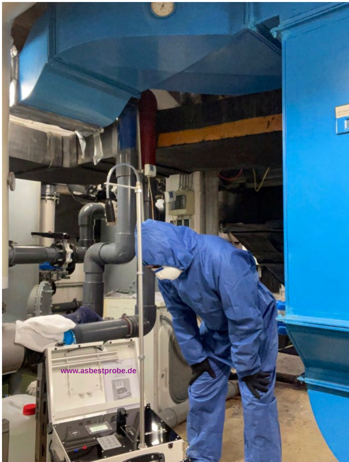
Abbildung 24: Status quo Messung nach Asbest-Faserfreisetzung durch unsachgemäße Bearbeitung
