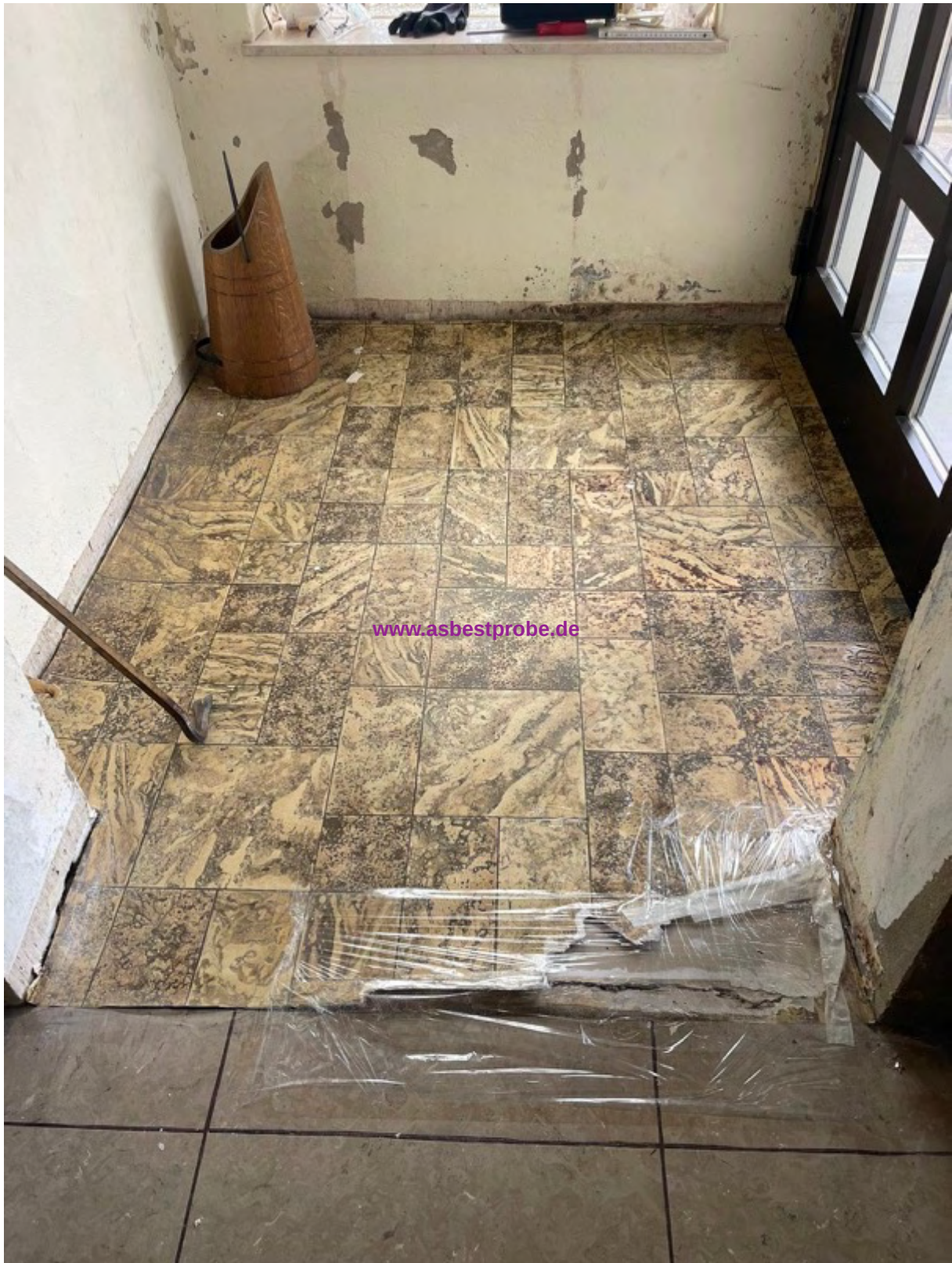
Abbildung 36: asbesthaltiger Bodenbelag (Cuschion-Vinyl)
