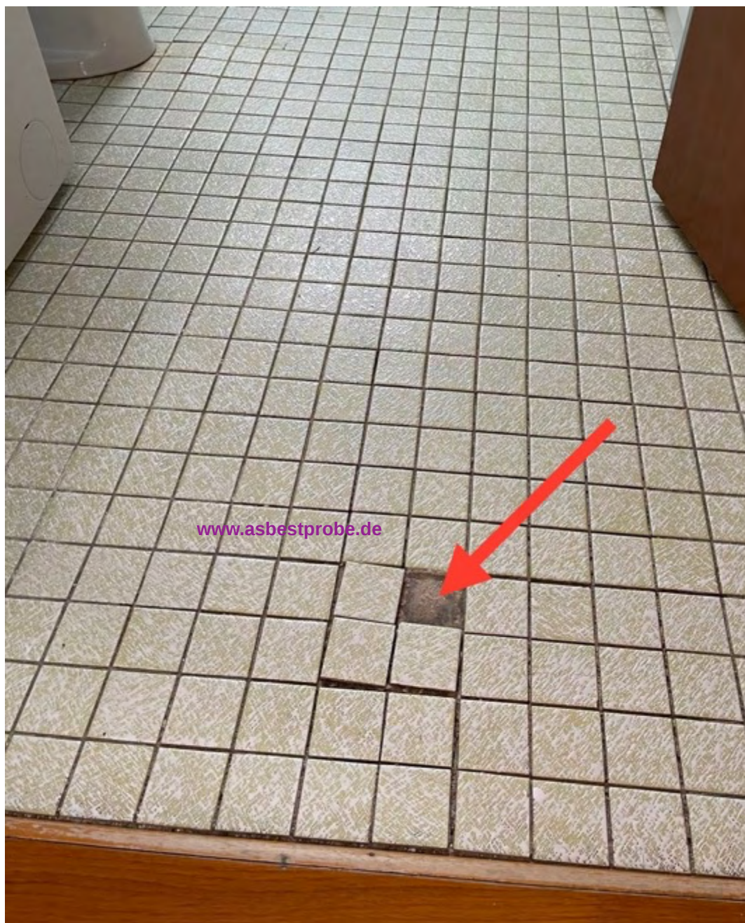
Abbildung 34: asbesthaltiger Fliesenkleber im Kleinformat
