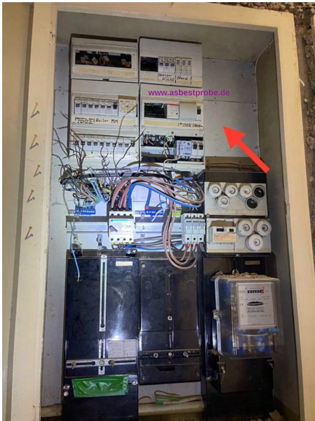
Abbildung 35: asbesthaltige Leichtbauplate in einem Verteilerschrank
