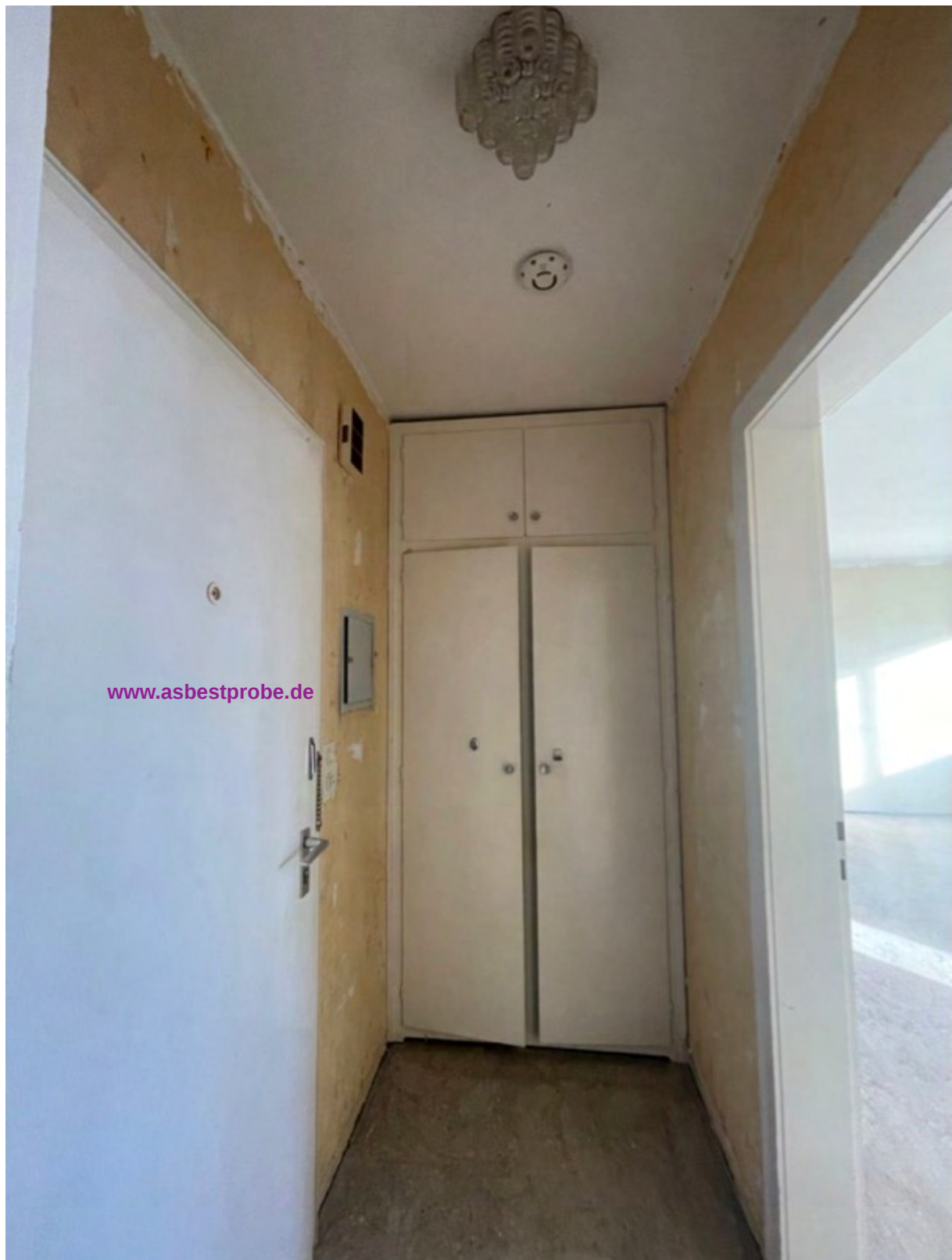
Abbildung 17: Asbesthaltiger Wandverputz in einem Flur, Mehrfamilienhaus
