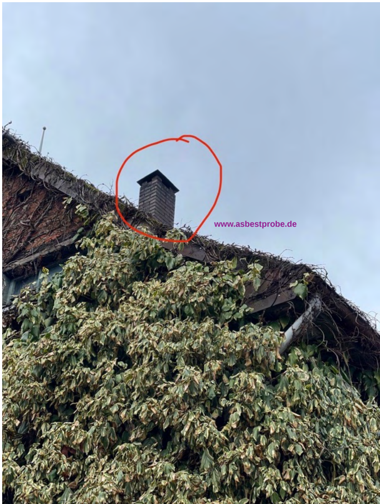
Abbildung 6: Verdachtsmoment, asbesthaltige Kaminabdeckung
