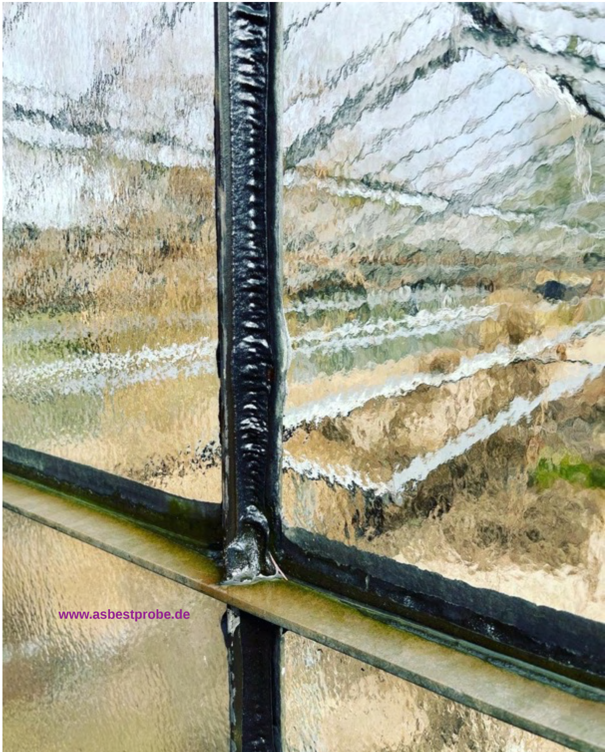
Abbildung 5: Asbesthaltiger Fensterkitt in einem alten Gewächshaus
