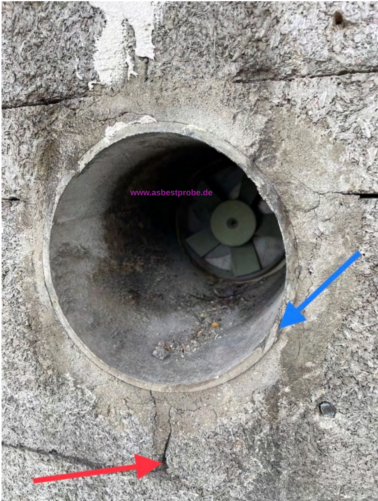
Abbildung 12:asbesthaltiges Abluftrohr einer Küche mit asbesthaltigem Mörtel in der Fassade verbaut
