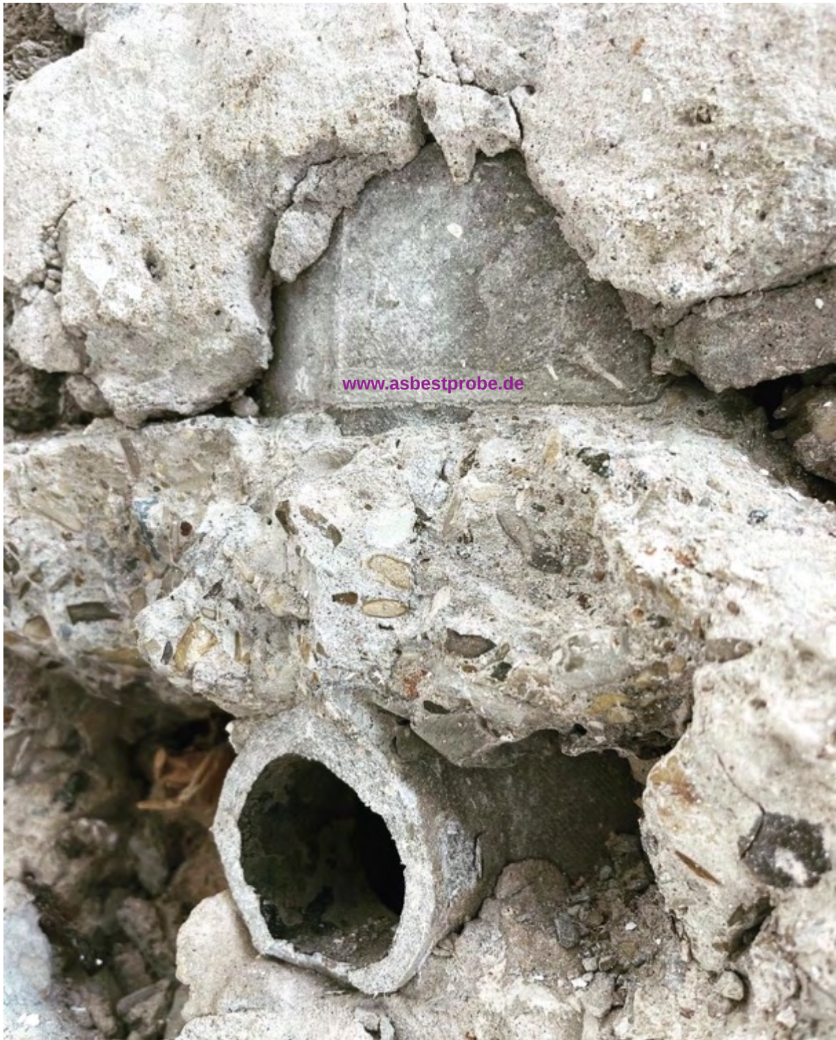
Abbildung 11: Regenwasserrohr in der Fassade, asbesthaltig
