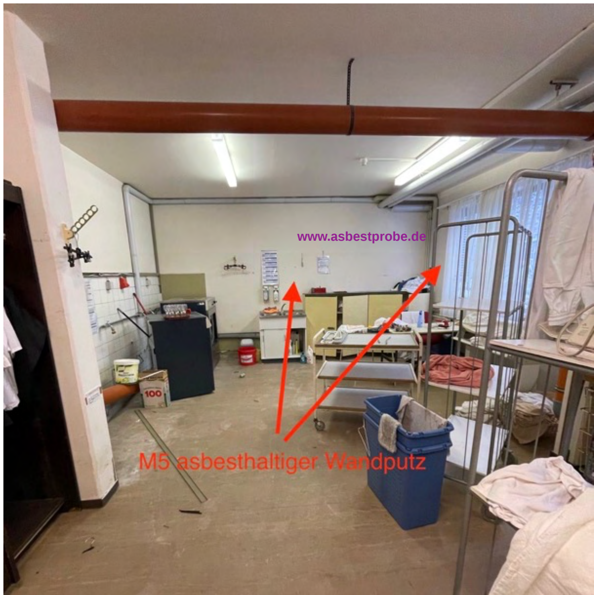
Abbildung 20: Wandverputz, nur diese zwei Wände mit asbesthaltigem Verputz, in einem Gebäude mit einer Grundfläche von ca. 600qm
