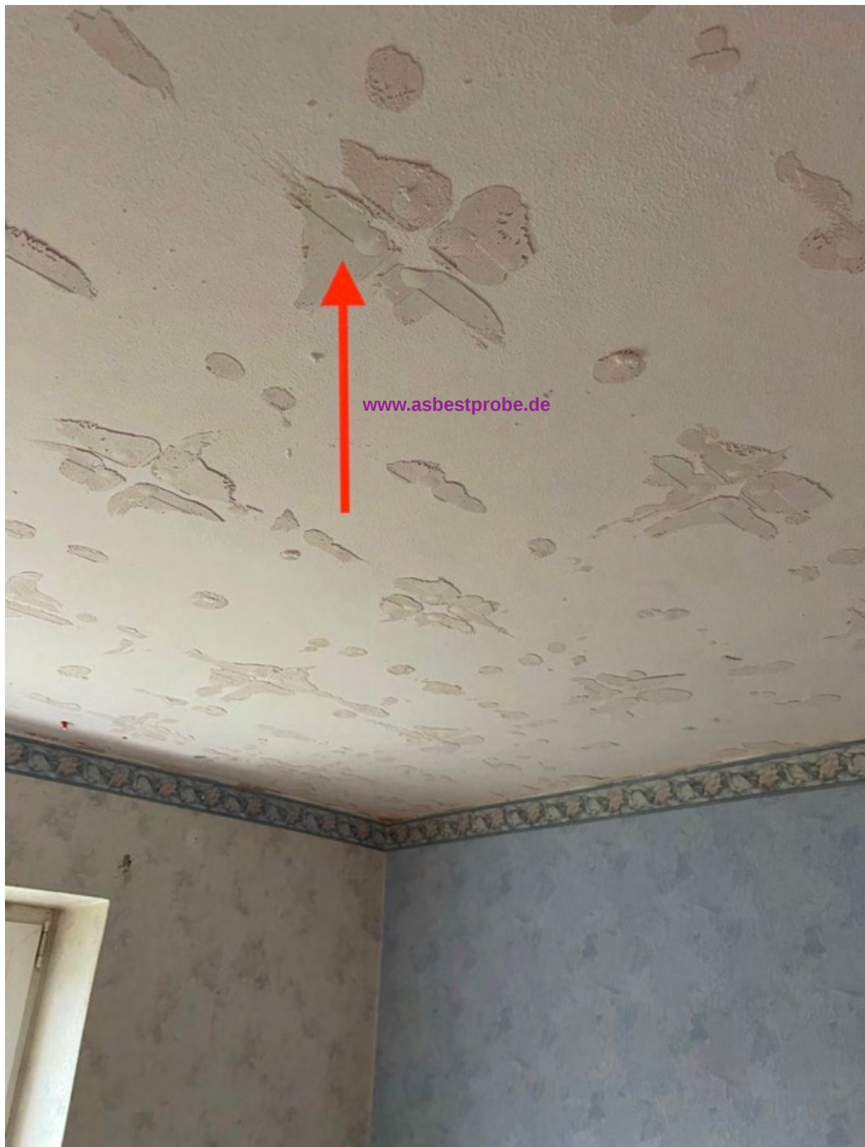
Abbildung 29: Asbesthaltiger Kleber der Styropor-Deckenplatten, diese wurden zuvor nicht fachgerecht entfernt
