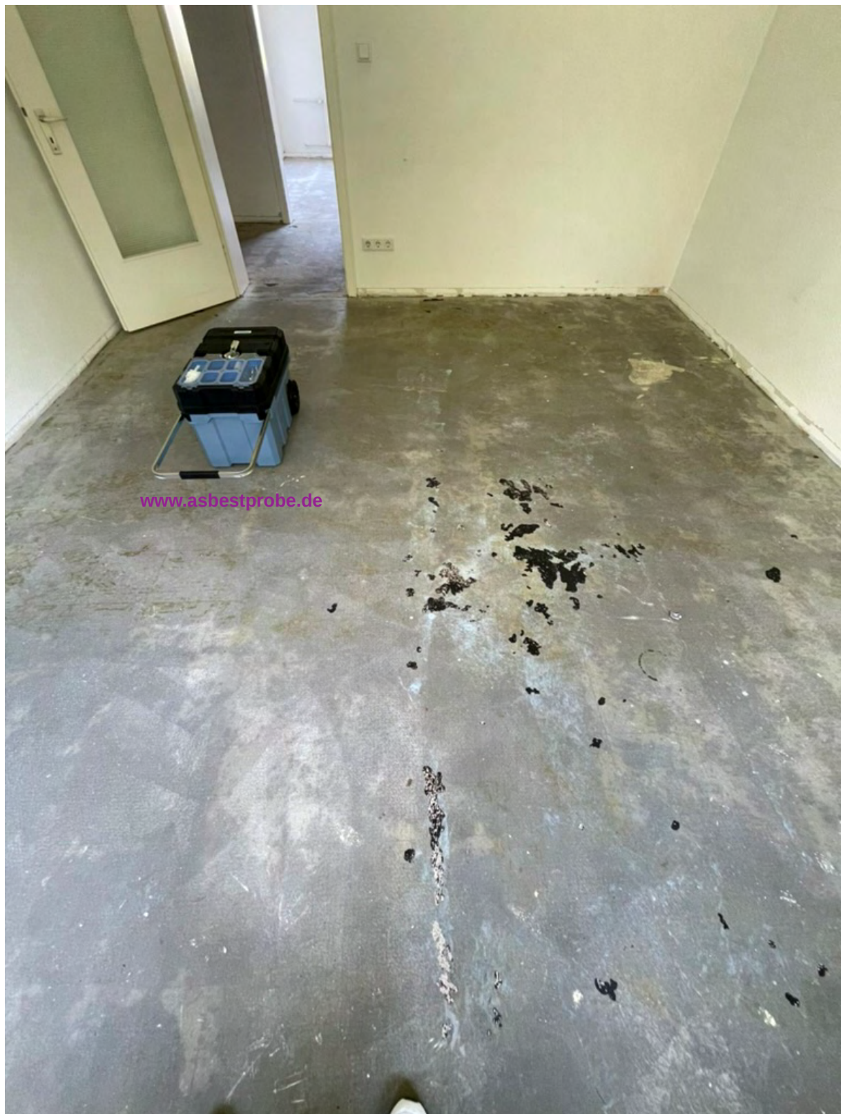
Abbildung 53: übergespachtelter asbesthaltiger Bodenkleber
