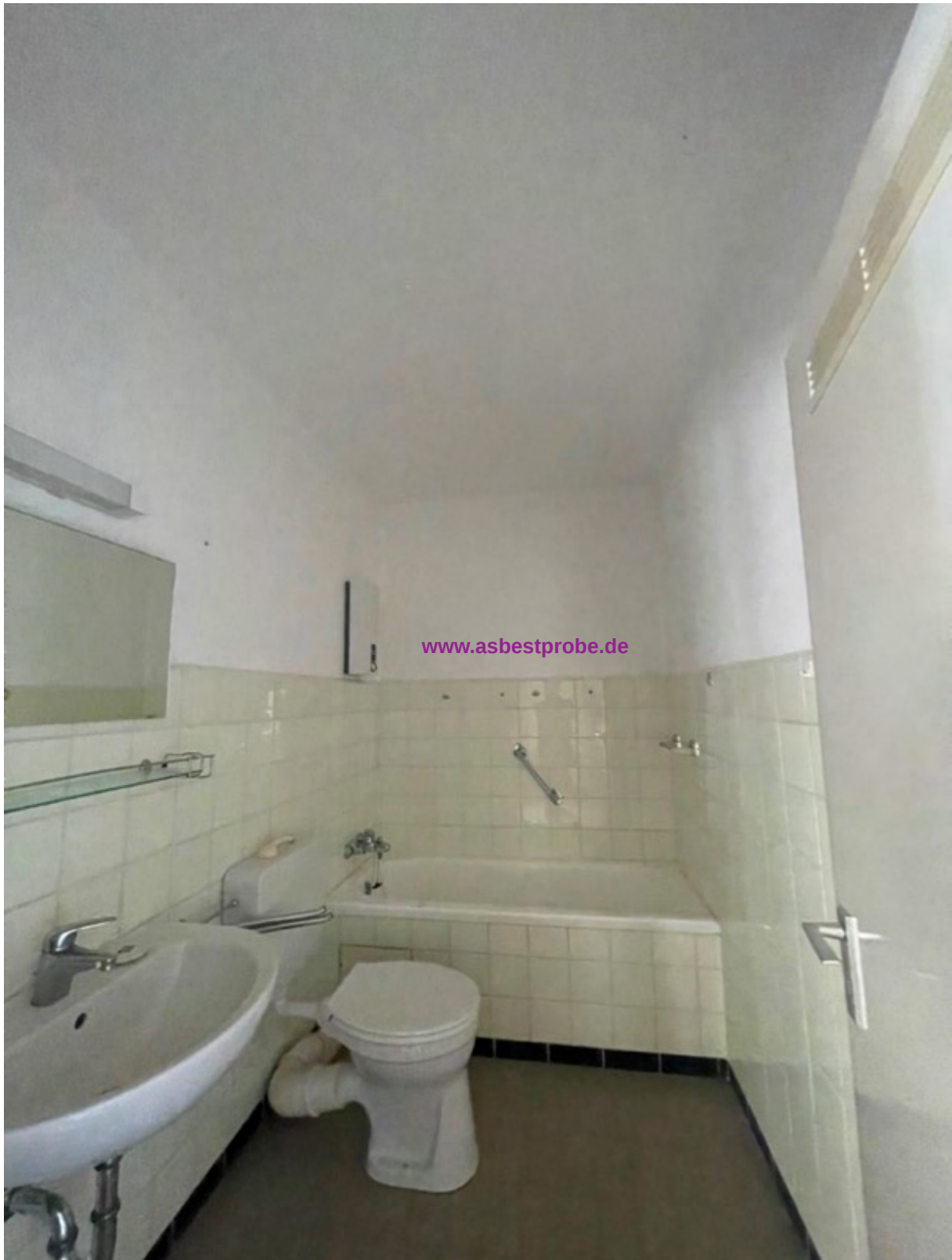
Abbildung 18: Asbesthaltiger Wandverputz in einem Bad, im Fliesenkleber kein Asbestnachweis
