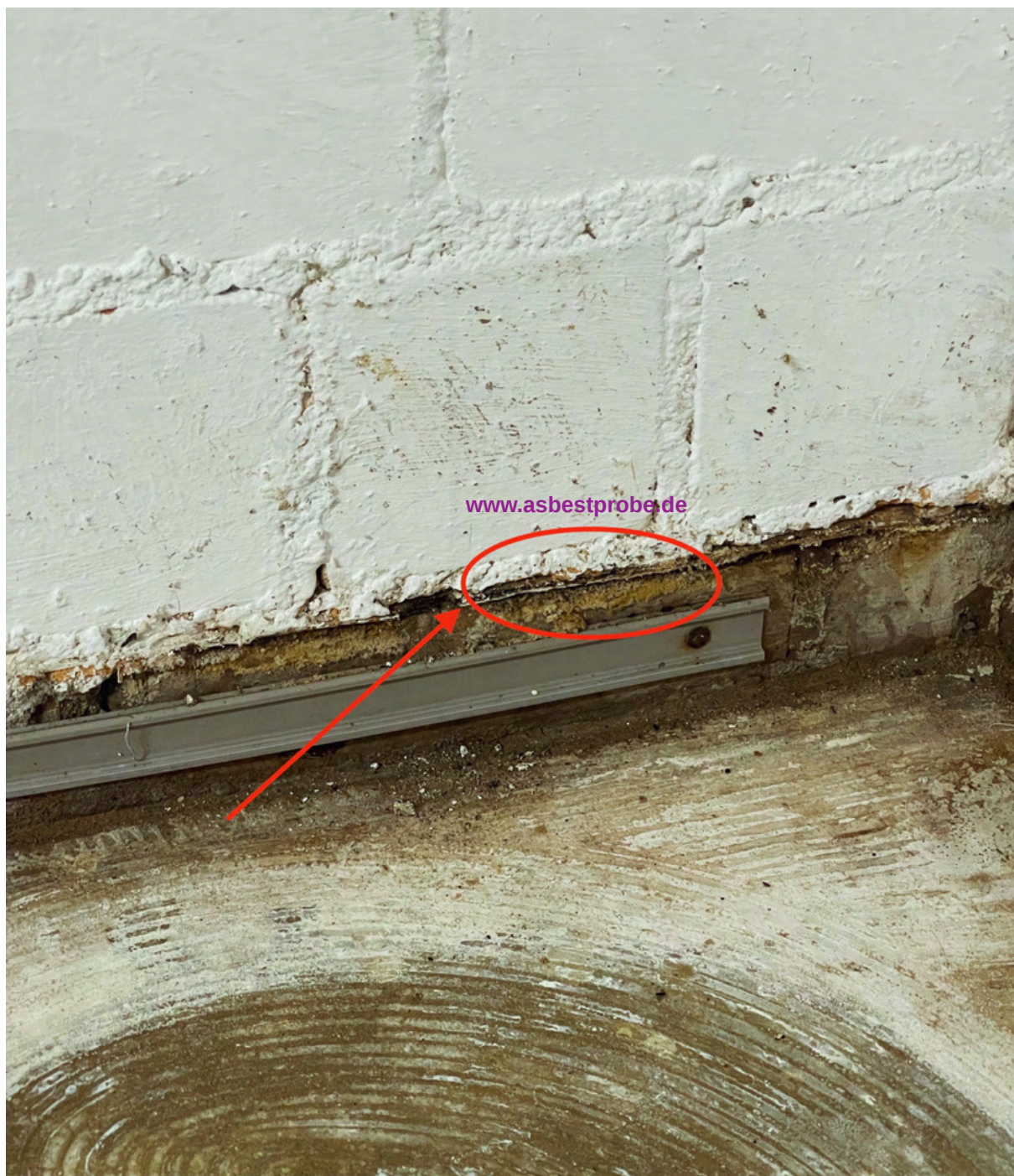
Abbildung 46: Asbesthaltige Mauersperrbahn, Vorsicht bei der Kellersanierung!
