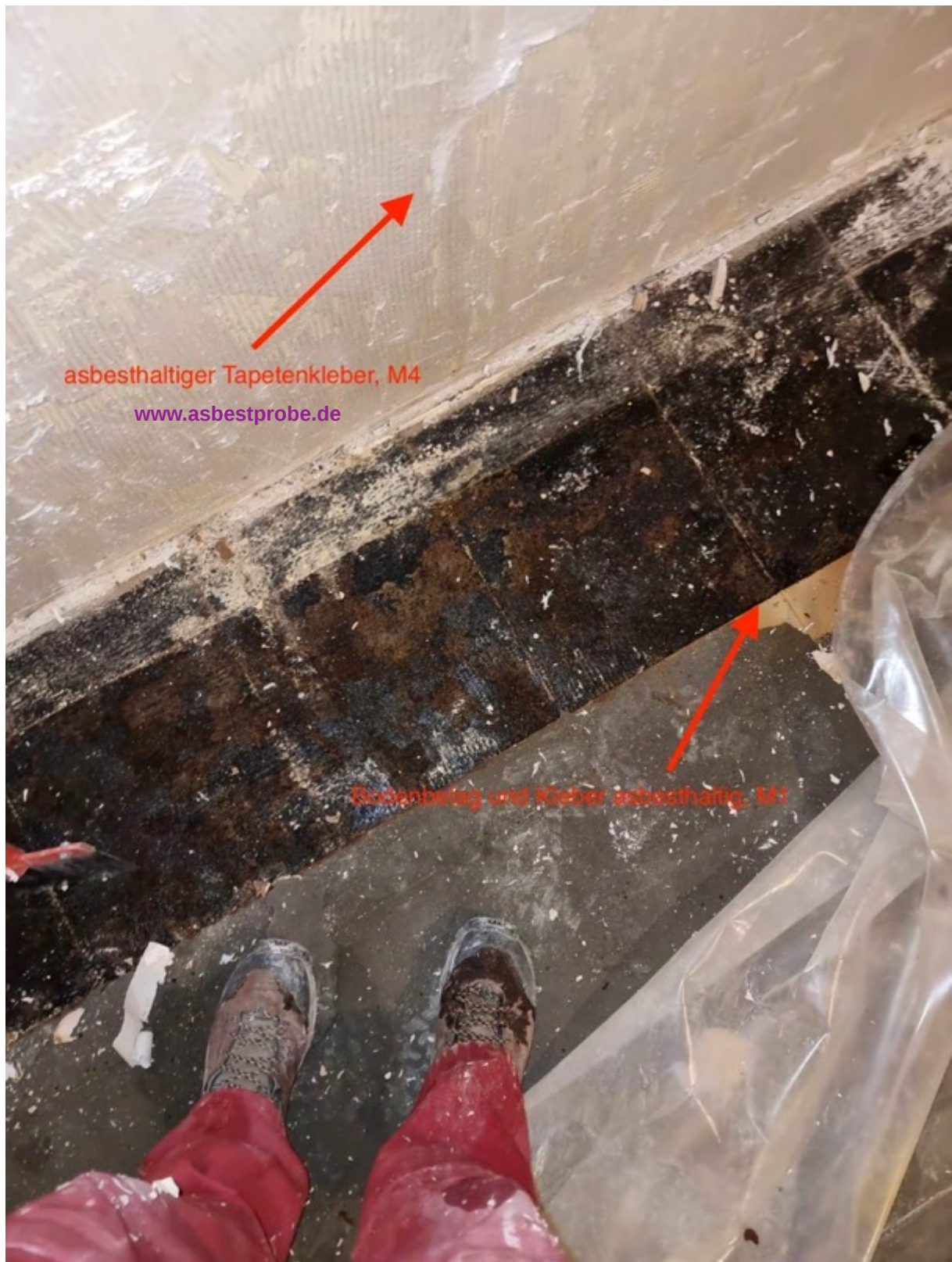
Abbildung 30. Doppelpack, asbesthaltiger Tapetenkleber an der Wand und asbesthaltiger Bodenkleber
