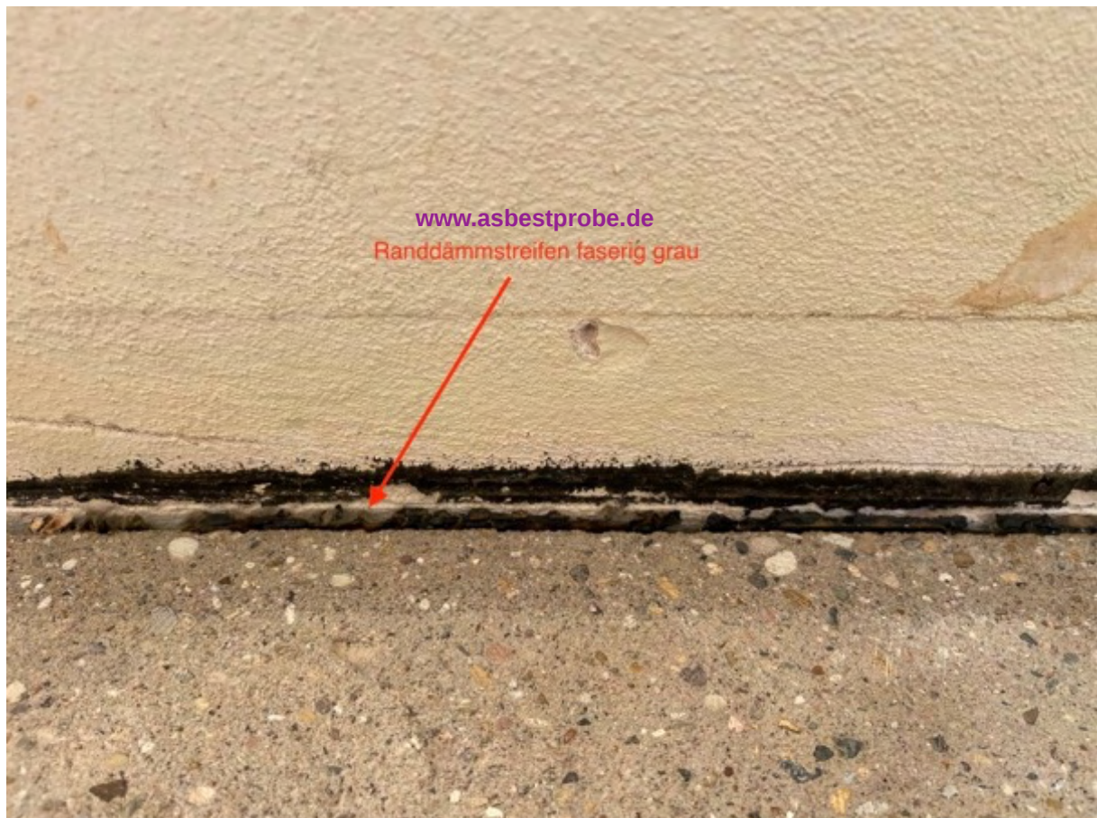
Abbildung 19: asbesthaltiger Randdämmstreifen einer Estrichkonstruktion, Kontamination durch die Sanierung des asbesthaltigen Bodenklebers. Eine komplette Randfugensanierung war die logische Folgerung
