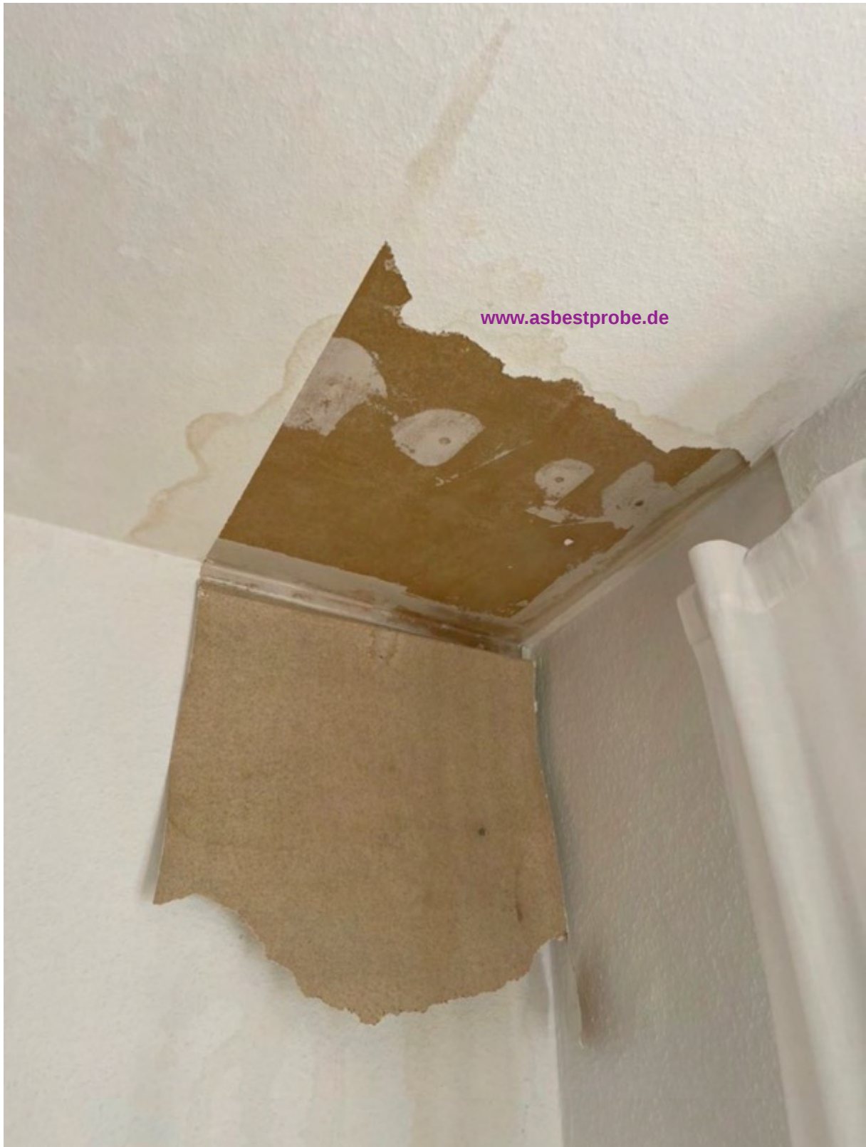
Abbildung 2: Spachtelmasse an alter Gipskartondecke, untersucht im Zuge einer Wasserschadensanierung
