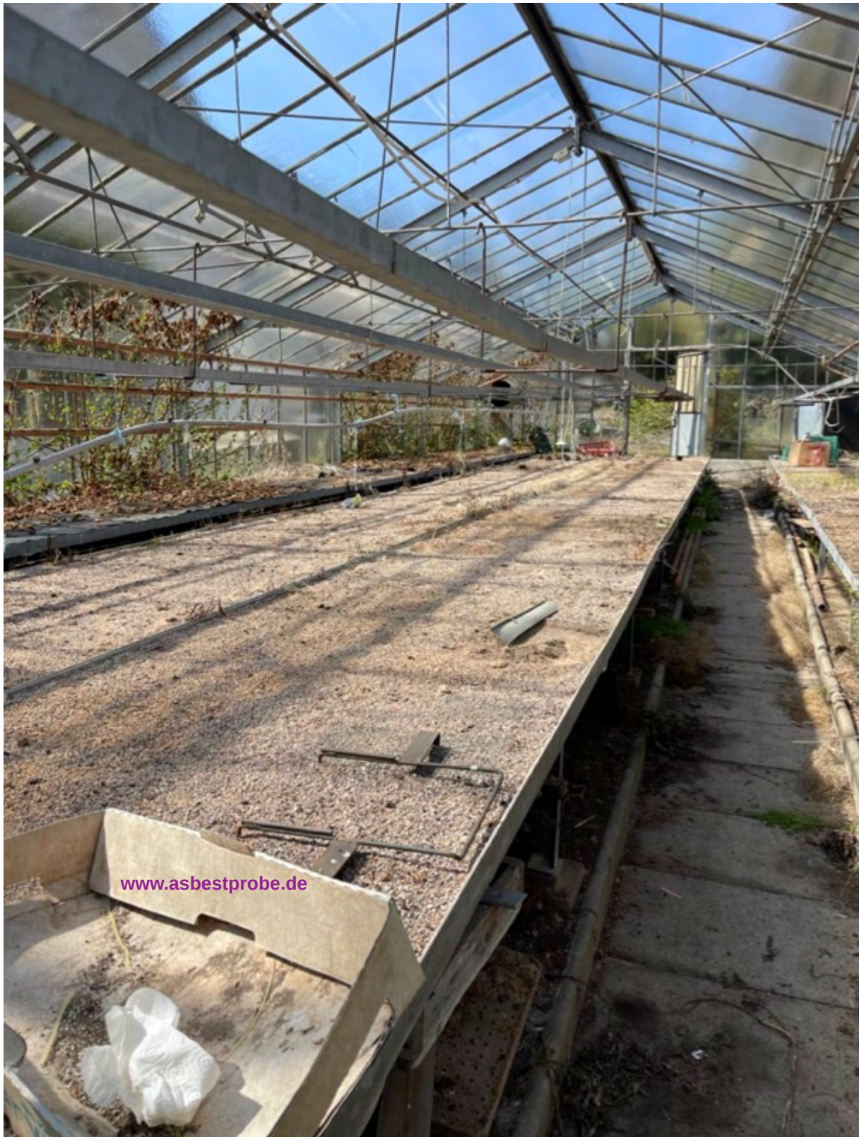
Abbildung 25: Pflanztische in einem Gewächshaus, der Bodenbelag der Tische besteht aus Asbestzementplatten
