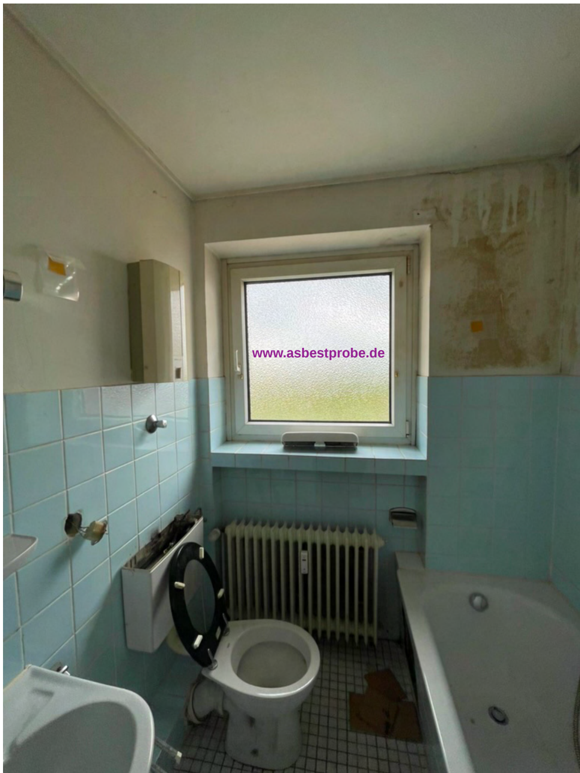
Abbildung 58: Fliesenkleber der Wandflächen asbesthaltig
