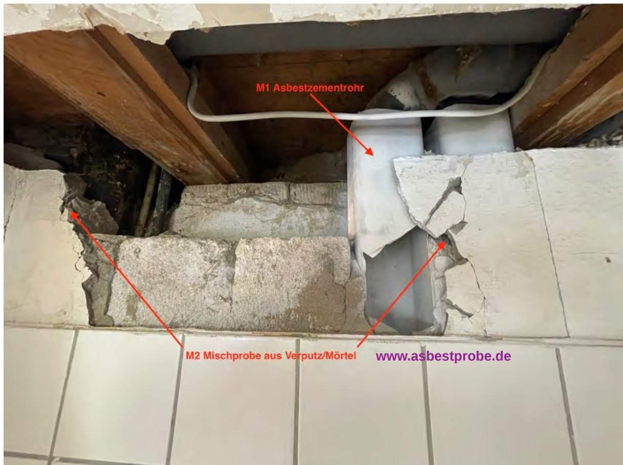
Abbildung 54: Lüftungsrohr und Verputz asbesthaltig, Vorsicht bei der Badsanierung
